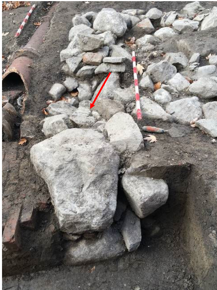
Photo 34. Lien entre le muret nord du caniveau et le mur sud du bâtiment des latrines, vue vers l'ouest (vestiges 67 et 66; BjFi-24-22- NUM2-122)
